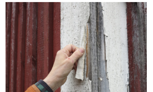
Plast- och alkydfärger hindrar fukten i konstruktionen från att avdunsta och åldras genom att lossna i fula flagor. Alkydfärgen bildar en hård hinna, som flagnar då den åldras. Plastfärgen bildar en hinna som lossnar i strimlor.
